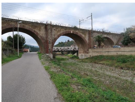
Le pont ferroviaire sur la Baillaurie. 2021. Vue de la face est. Au second plan le pont métallique remplaçant l'ancien pont de pierre.
